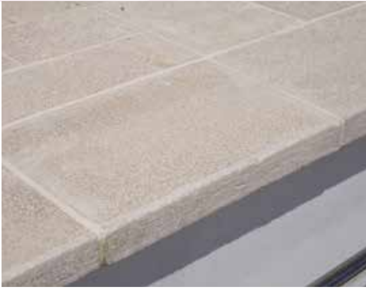
Margelles de piscine
